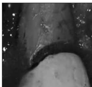
Fig. 5. Fisura y filtración coronaria.
